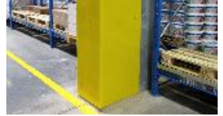
Anfahrerschutz für Betonpfeiler
